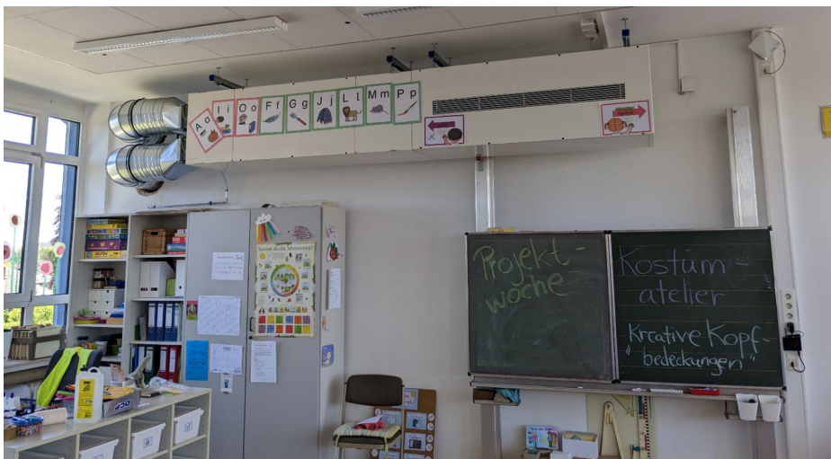
Abbildung 1: Installiertes Lüftungsgerät der Firma Drexel & Weiss, Modell Aeroschool 600 mit Deckenmontage und Kanaldurchführung durch die Fassade mittels Kernlochbohrungen. Die Kanaldämmung steht hier noch aus
