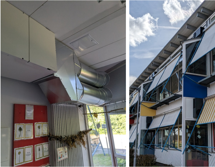
Abbildung 2: Fertig gedämmte und ummantelte Kanäle in einem Klassenraum mit Durchführung durch ein Fensterelement (links). Außenansicht der Fassade kombinierten Außen- und Zuluftelementen (rechts).
